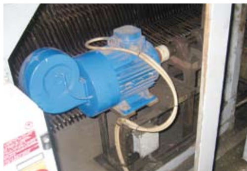
Trasmissione forno: tensionamento catena Oven transmission: chain tensioning
